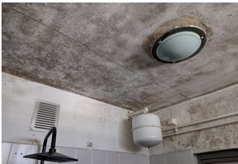
Zwarte schimmelplekken op het plafond en de muren in de badkamer van een van de bewoners.
